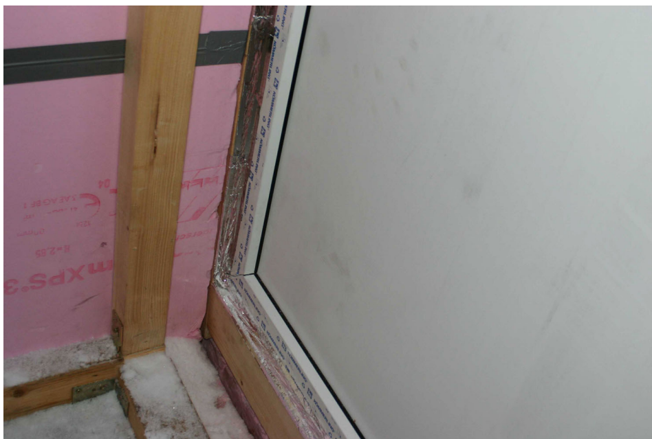
Photo 2 Fracture d'angle côté froid
