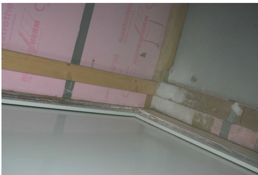
Figure 2 Fracture d'angle sur le côté froid (grand panneau)
